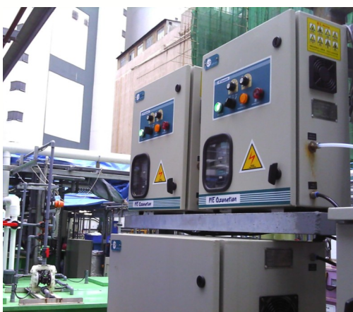
電鍍生產線氰化物處理
