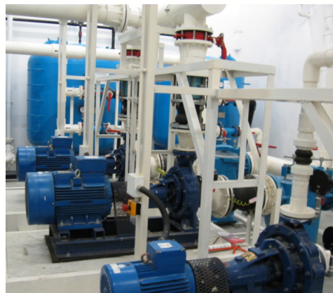
泳池過濾泵房
